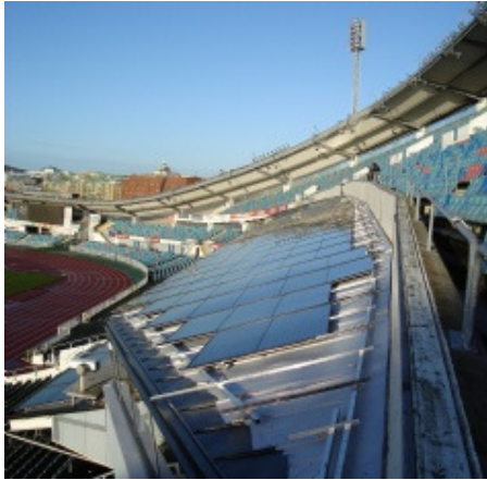
Pav. 7.3 Fotoelektros moduliai instaliuoti Ullevi sporto arenoje Gothenburge, Švedija. Fotomoduliai gamina energiją visai arenos apšvietimo sistemai. (Šaltinis: Switchpower ir GotEvent).
